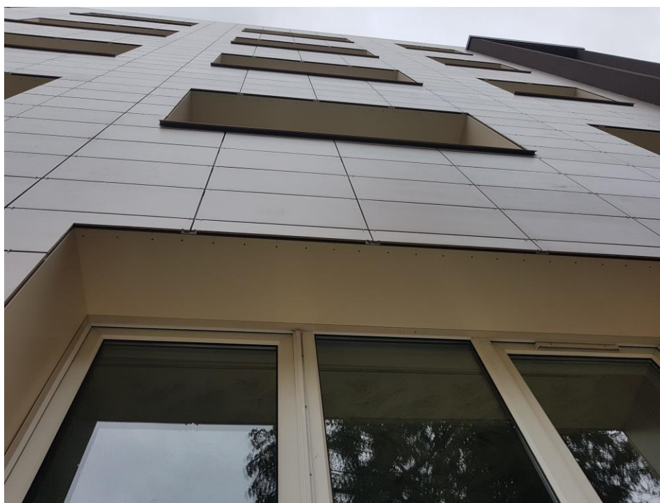
Світлина 16. Улаштування вузла віконної конструкції (з провітрювачем) в системі фасадної теплоізоляції з вентиляльованим повітряним прошарком
