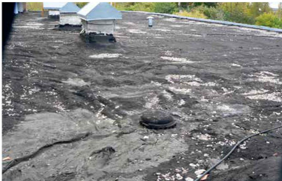
Світлина 11. Фрагмент плоскої суміщеної покрівлі зі зношеним покриттям
