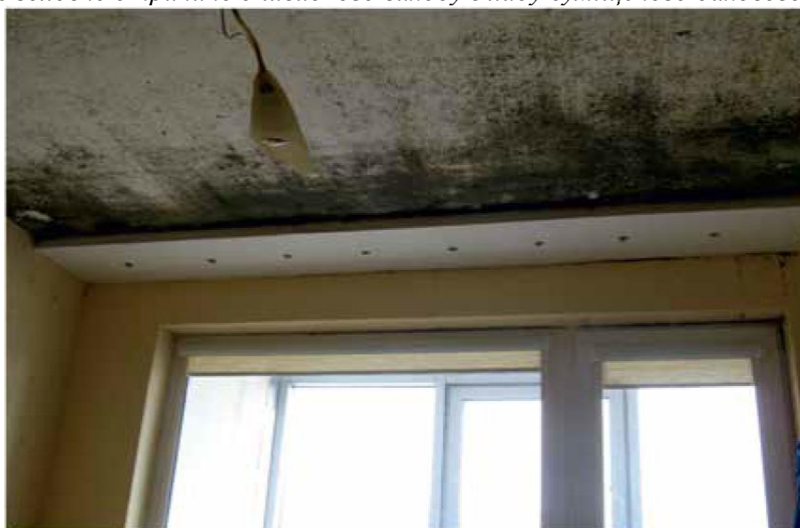
Світлина 10. Наслідки конденсатного зволоження конструкції суміщеного покриття
