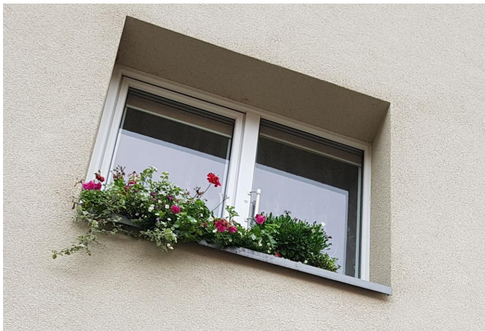
Світлина 15. Монтаж вікна з утепленими зовнішніми відкосами, улаштуванням відливу та захищеним від зовнішнього впливу монтажним швом
