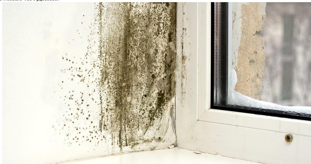
Світлина 14. Ураження віконних відкосів пліснявою внаслідок неякісного встановлення вікна
