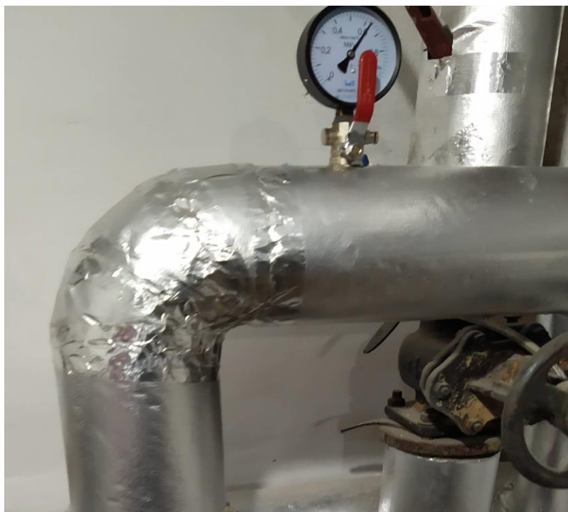
Світлина 9. Фрагмент теплоізолюваного трубопроводу
